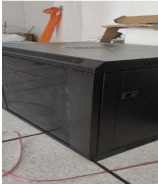
Gambar 3.6.2. Rack Perangkat Jaringan
